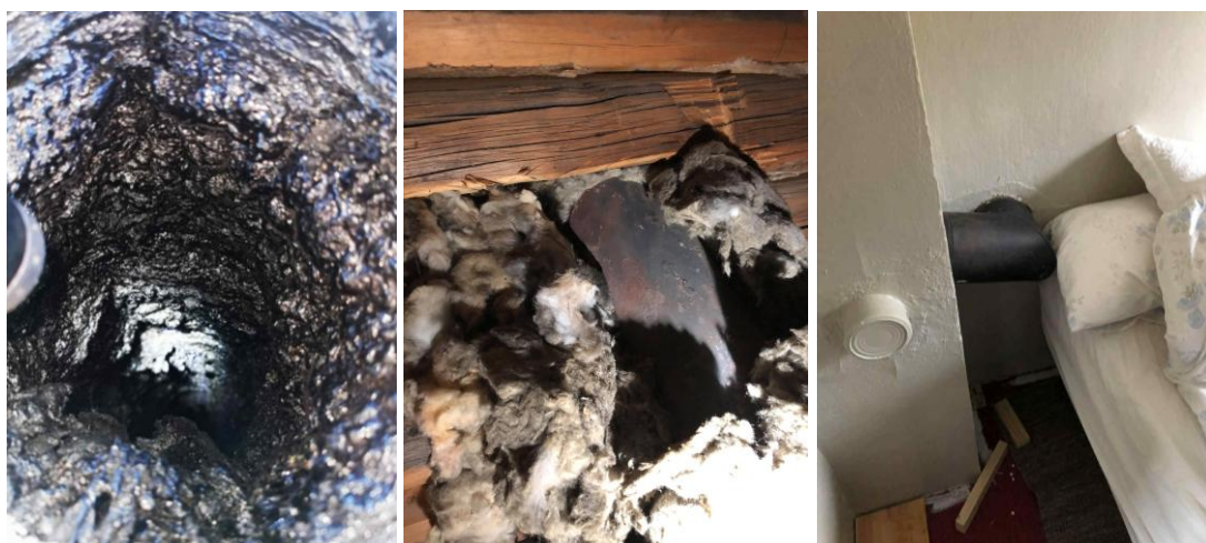
Funn ved boligtilsyn og feiing, der tiltak forhindrer potensiell brann. Foto: VBR IKS
